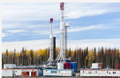
Puits de gaz
